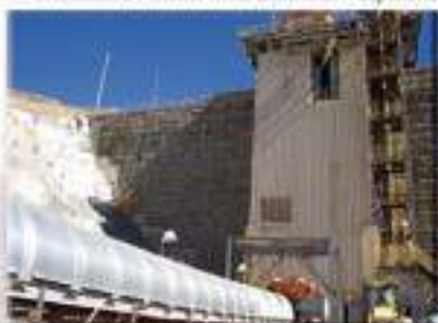
Chancadora Primaria Mina Alto Chicoma - Barrick
